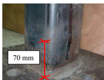
(d) Deformation of RuPCHS-20 (right face)
