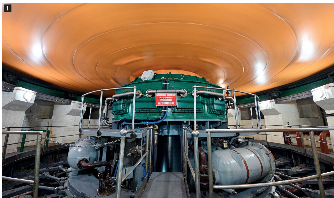
Fot. 1 Pracujący hydrozespół (łożysko nośne, wirnik generatora)
