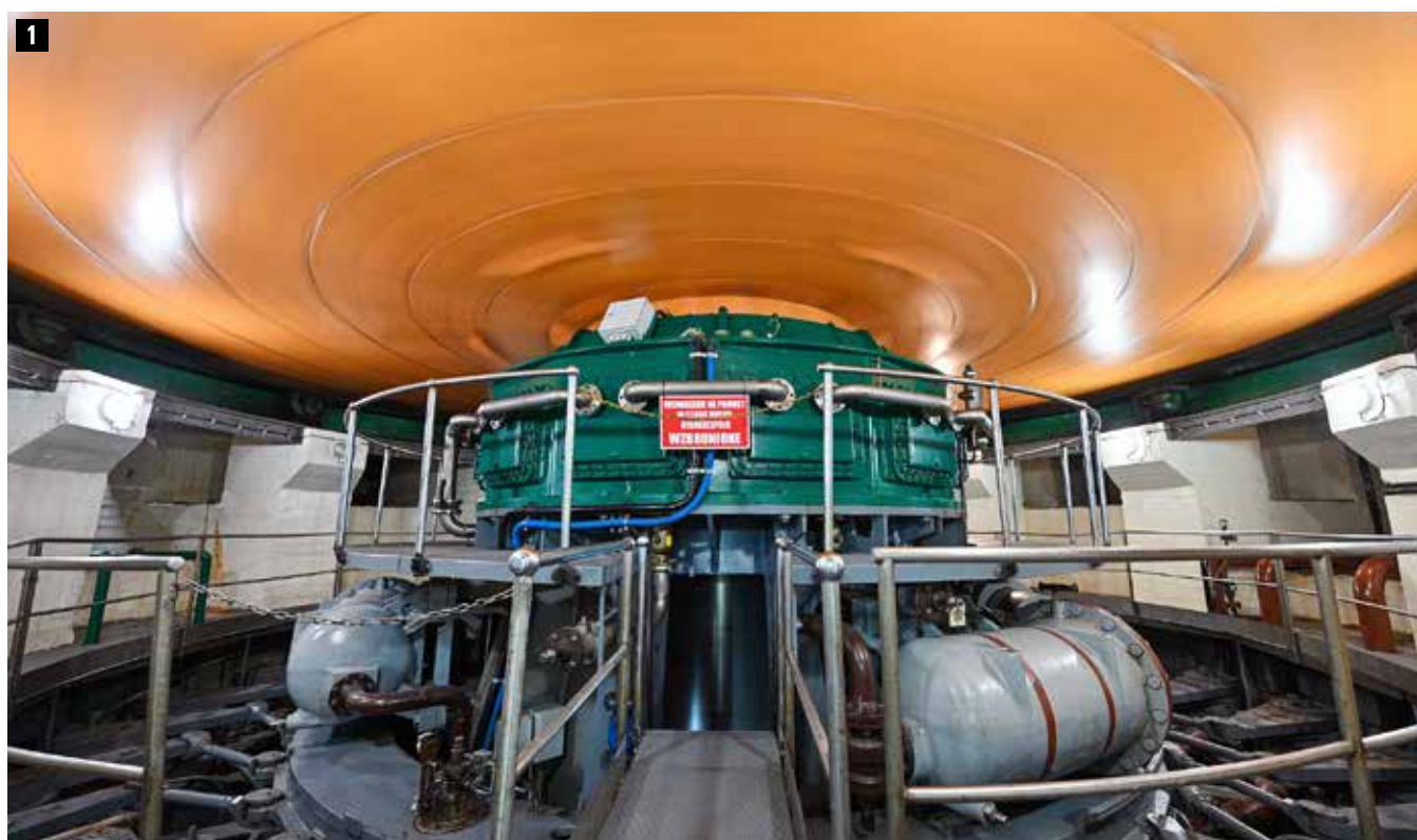
Fot. 1 Pracujący hydrozespół (łożysko nośne, wirnik generatora)
