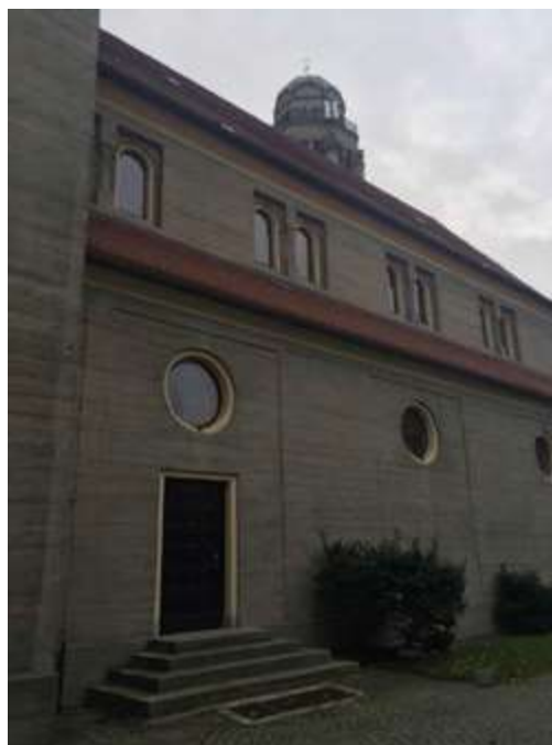
Ryc. 3. Fragment elewacji północnej z widocznymi śladami deskowań.
