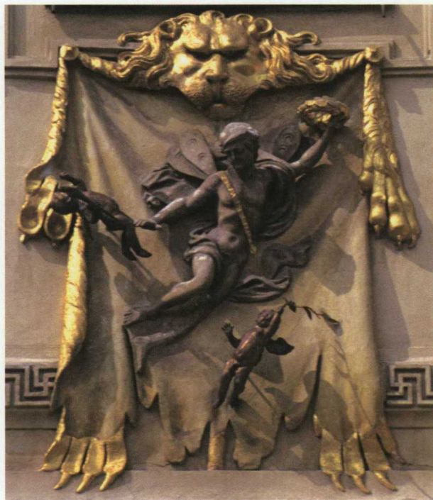
Fragment dekoracji elewacji ogrodowej pałacu w Wilanowie przed ostatnimi pracami konserwatorskimi
