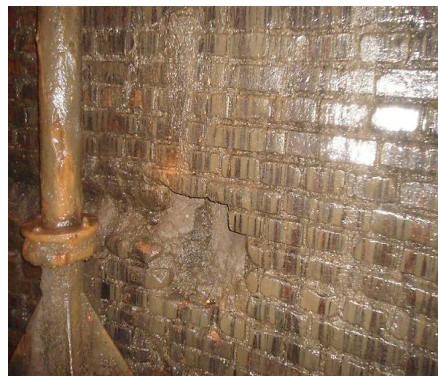
Rys. 10. Przykładowe głębokie ubytki obudowy murowej
