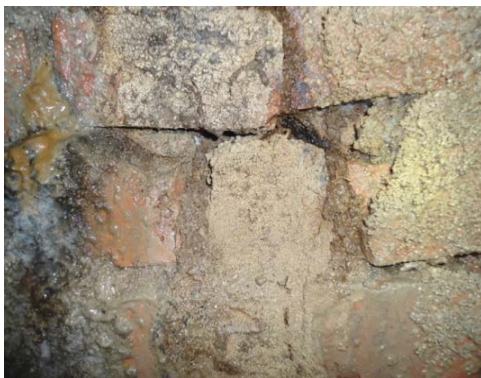
Rys. 19. Lekkie sączenie wody zza obudowy szybu
