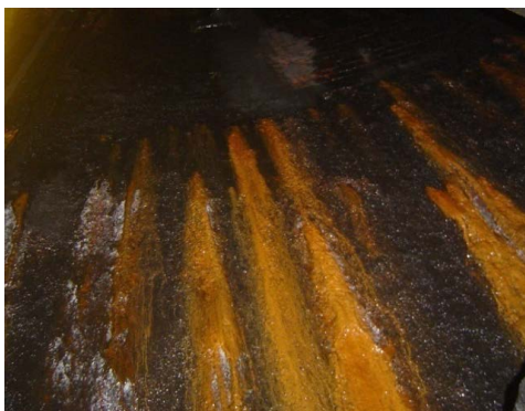
Rys. 15. Wycieki i sączenia wody zza obudowy
