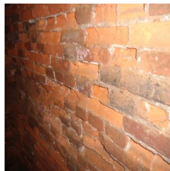
Rys. 2. Powierzchniowe zruszczenia obudowy murowej z cegiel Fig. 2. Surface scaling of brick lining
