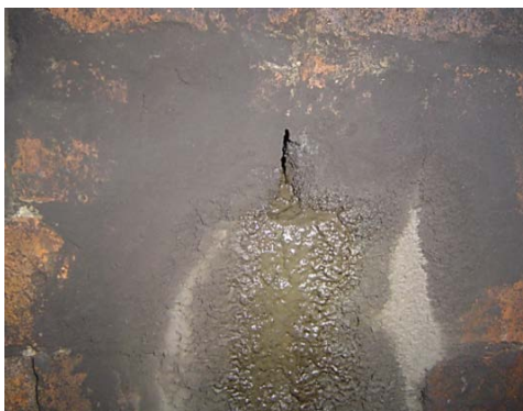
Rys. 17. Wyciek z nieszczelnej spoiny
