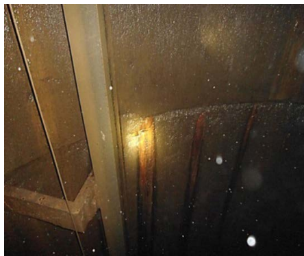
Rys. 18. Wyciek na połączeniu technologicznym
