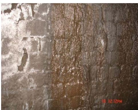
Rys. 13. Zanieczyszczenie obudowy pyłem węglowym Fig. 13. Contamination of support through the coal dust
