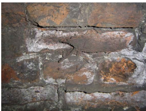
Rys. 11. Korozja obudowy murowej Fig. 11. Corrosion of the brick lining
