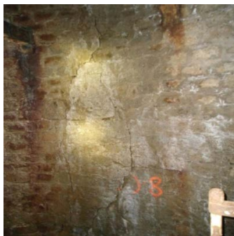
Rys. 1. Spękania obudowy murowej z bentonitów Fig. 1. Fractures of bentonite brick lining
