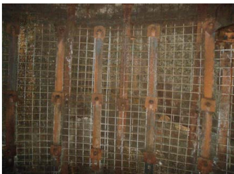
Rys. 5. Kawerna zabezpieczona przykotwioną siatką stalową z okładzinami
