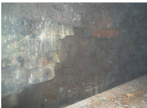
Rys. 1. Ubytki obudowy murowej
