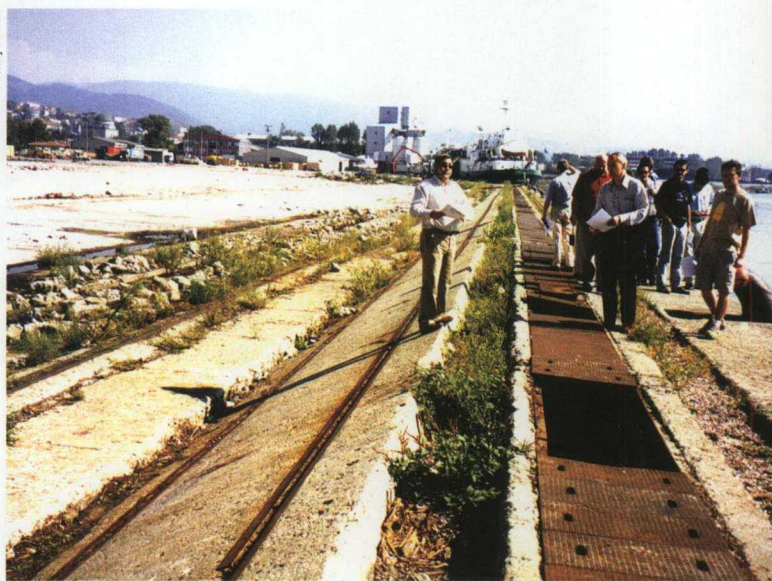
Zniszczone i przesunięte wskutek upłynnienia gruntu nabrzeże w porcie Derince (Turcja)
