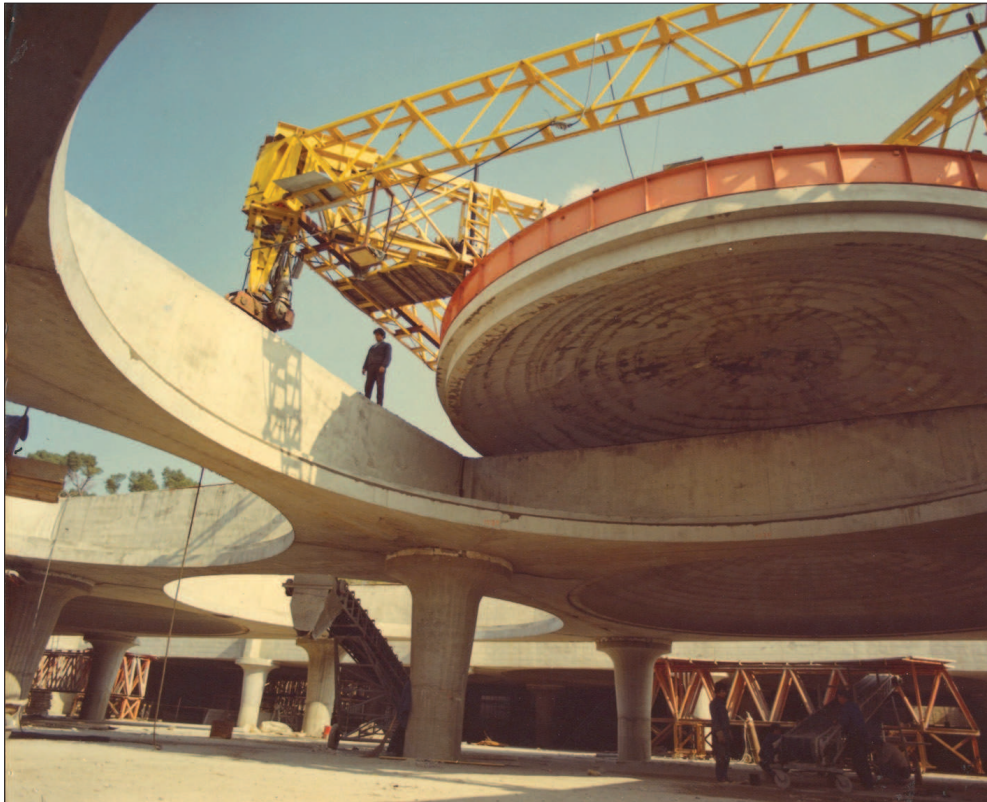
39. L. Moretti, Podziemny parking Villa Borghese (1965-1972), montaż elementów prefabrykowanych, wykonanych poza terenem budowy. Archivio Centrale dello Stato, Rzym 39. L. Moretti, Villa Borghese underground Parking Garage (1965-1972), views of the assembling of prefabricated elements, built outside the construction site. Archivio Centrale dello Stato, Rome
