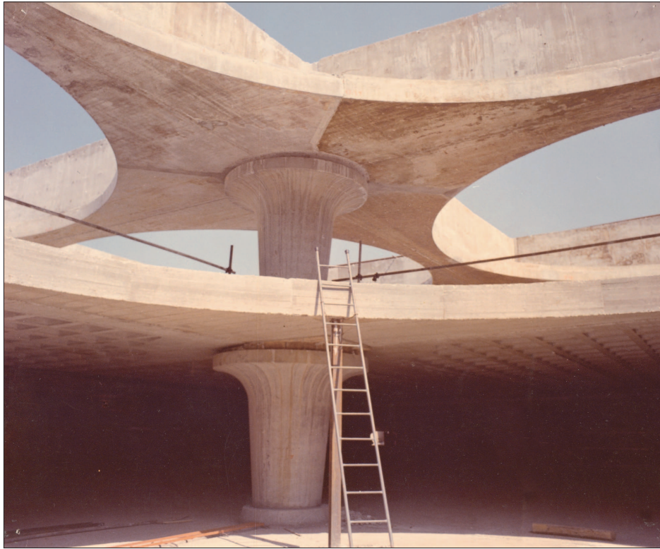
40. L. Moretti, Podziemny parking Villa Borghese (1965-1972), montaż elementów prefabrykowanych, wykonanych poza terenem budowy. Archivio Centrale dello Stato, Rzym 40. L. Moretti, Villa Borghese underground Parking Garage (1965-1972), views of the assembling of prefabricated elements, built outside the construction site. Archivio Centrale dello Stato, Rome
