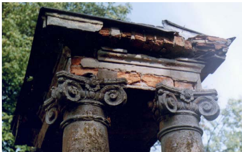
Ryc. 7. Fragment bramy wjazdowej 2 poł. XIX w., głowice kolumn, Żydowo gm. Rokietnica Fig. 7. A section of the entry gate, second half of the 19 th c., capitals of the columns, Żydowo
